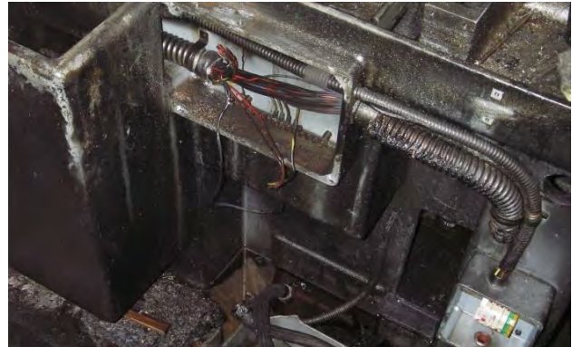
Bild 4: angeschmorte freiliegende Kabel
