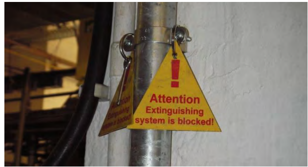
Bild 3: Blockieren der Löschanlage
